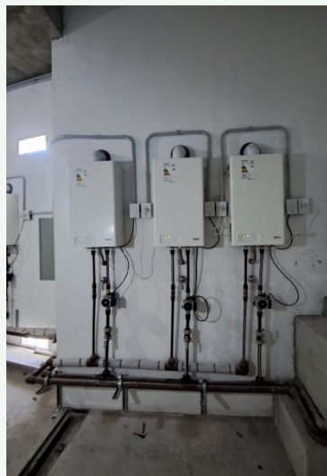
SALA DE MAQUINAS - CALDERAS 10° PISO
