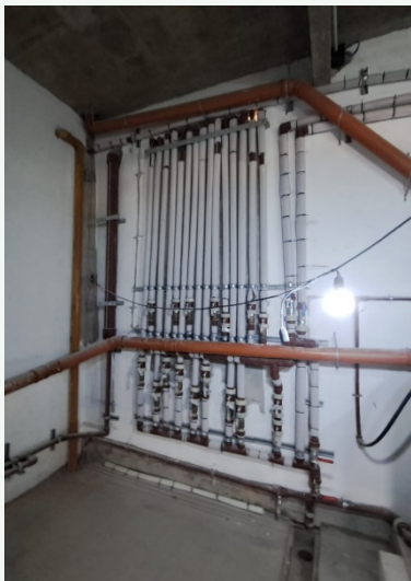
SALA DE MAQUINAS - CALDERAS 10° PISO
